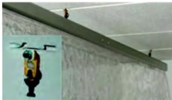
Compartimento ContainAire (primer plano del enlace de extinción de incendios)
