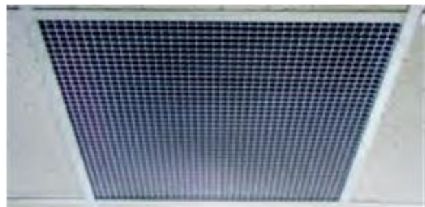
Rejilla de retorno del techo
